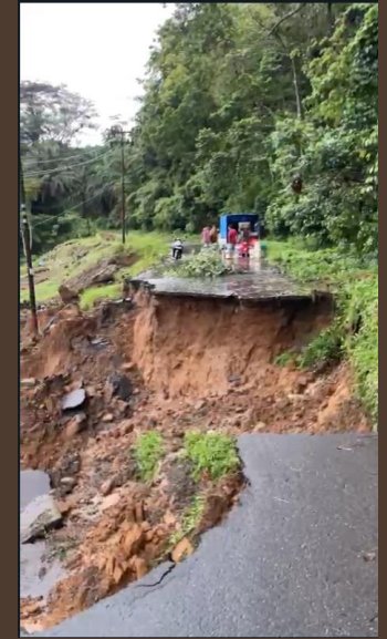
Jalan simpang empat panti terputus akibat jalan terbal
