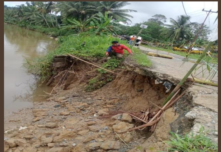
Longsor di Kec. Sipora Selatan
