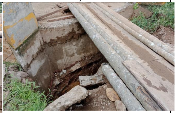
Gambar 12. Kondisi Jembatan Tanjung Botung
