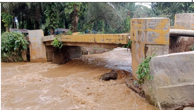
Gambar 11. Kondisi Jembatan Tanjung Botung
